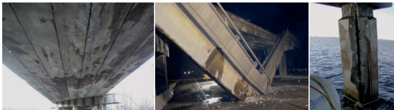
1. ábra: Jégolvasztó sózás és tengervíz okozta betonacél korrózió
